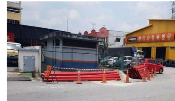
Kerja HDD Bagi Menaiktaraf Pembekalan Tenaga Elektrik Di Pak Tam Katering Sdn. Bhd.
