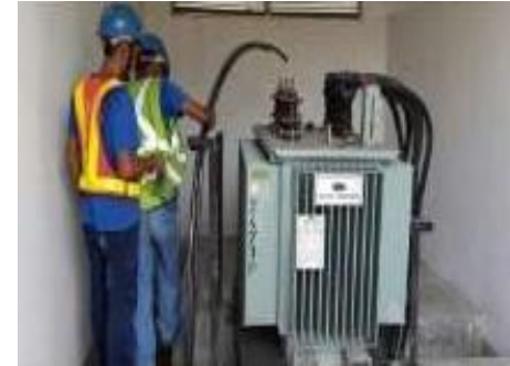
TNB Routine Preventive Maintenance - Penempatan Vendor Rakaniaga Strategik Negeri Selangor Bagi Skop Kerja Pencawang Elektrik (Pemasangan Baru & Senggaraan 11KV
