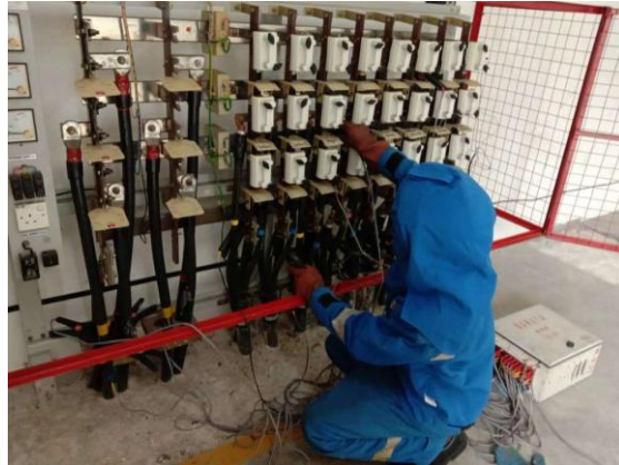
Mengambil bacaan beban di pencawang LVDB/Peti pembekal
